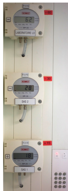
Manomètres de contrôle des pressions et clavier pour l'accès sécurisé
