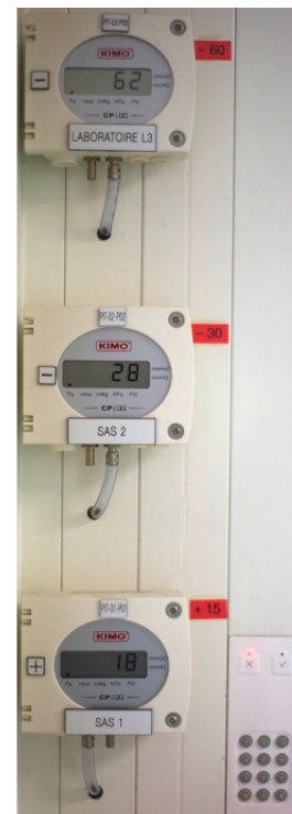
Manomètres de contrôle des pressions et clavier pour l'accès sécurisé
